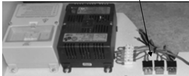
230V Sicherungsautomat, Ladegerät und 12V Sicherungen
